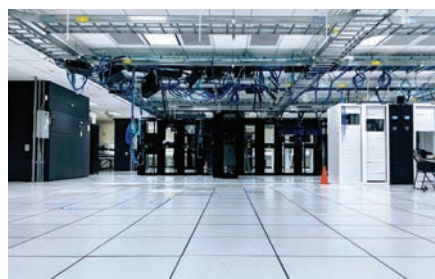
Datacenter och Telecom
