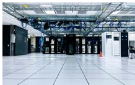
Datacenter och telecom
