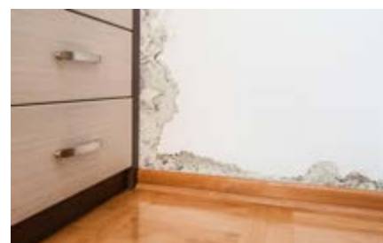
Восстановление после повреждения водой
