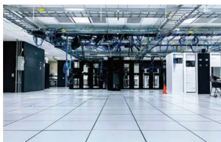
Centra telekomunikacyjne, centra danych
