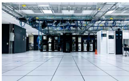
Centra telekomunikacyjne, centra danych
