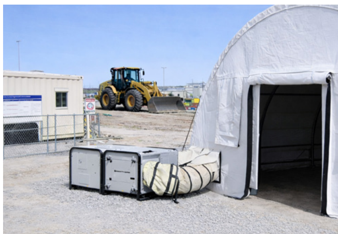
Installation avec les conduits d'air
