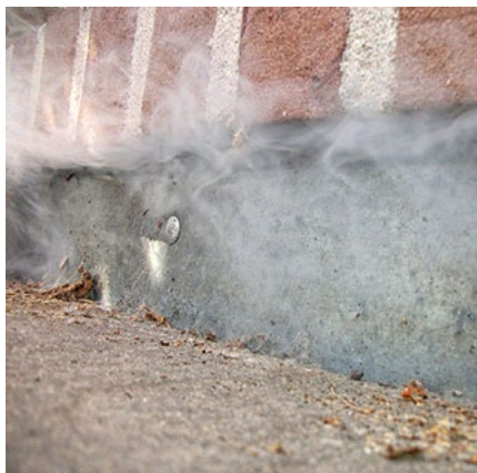
Bevis for mangelfuld tætning af vægforbindelserne over en parkeringskælder
