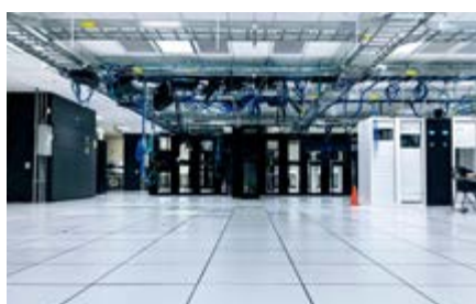
Rechenzentren und Fernmeldetechnik
