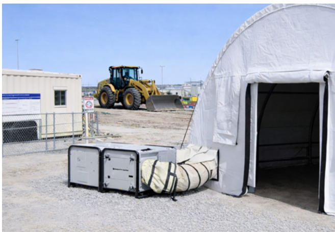
Installation mit den Luftkanälen
